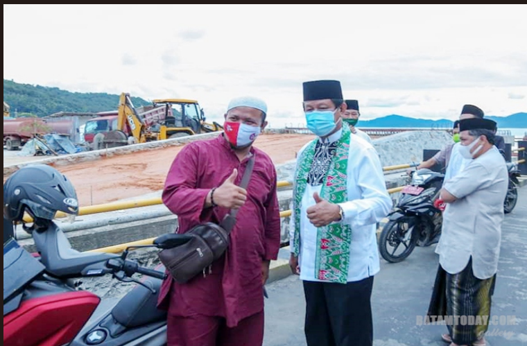
Gubernur Kepri didampingi Bupati, Wakil Bupati dan Sekda Anambas saat memantau progres pembangunan JI SP II
